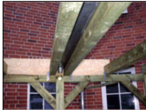
Ansicht von unten Lose eingelegte Regenrinne zwischen den Sparren
